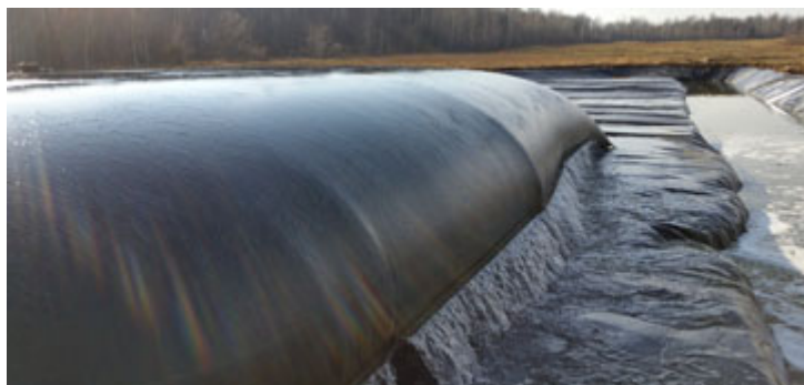
Figur 2: Exempel på avvattning av slam med geotub.
